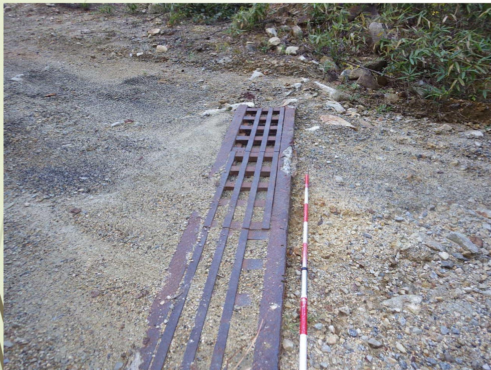
土砂詰まりにより水が流れない状態
