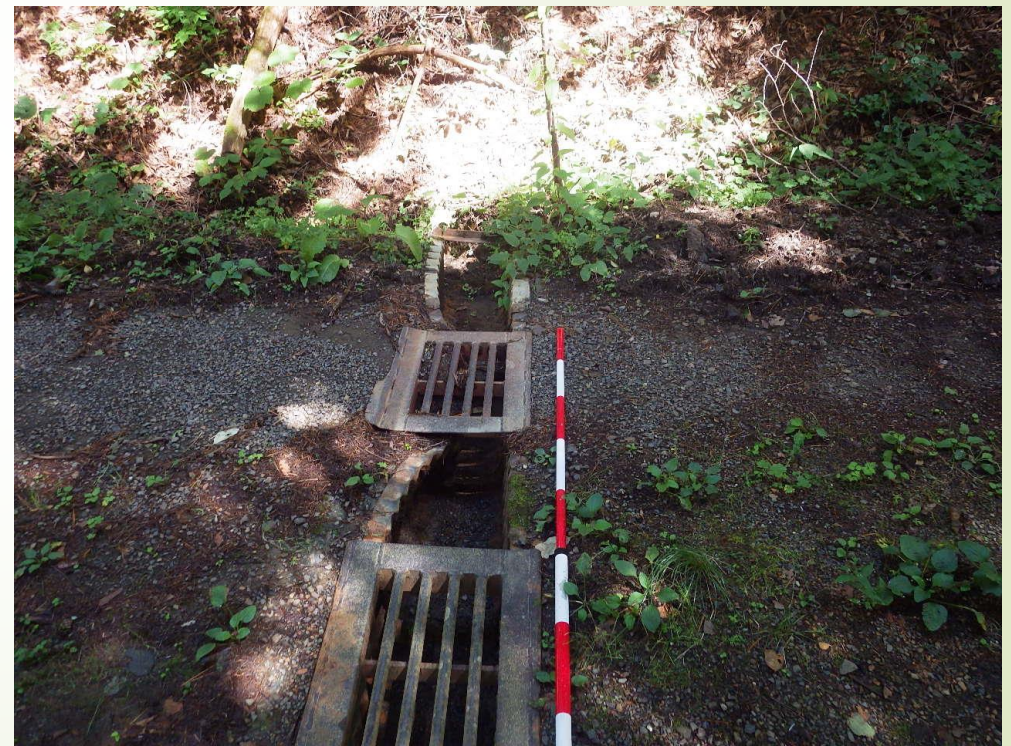
破損により蓋が不安定な状態
