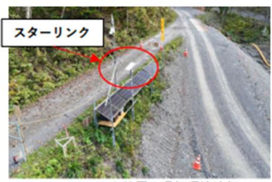
スターリンクを設置し通信環境確保
