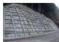
幹線林道のり面保全
