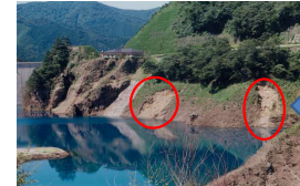
ダム湛水法面 残留間隙水圧による表層崩壊
