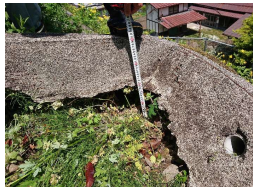
背面侵食による吹付枠の空洞化
