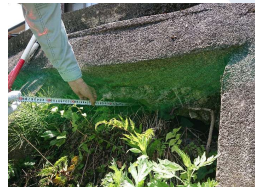
吹付枠端部背面空洞化
