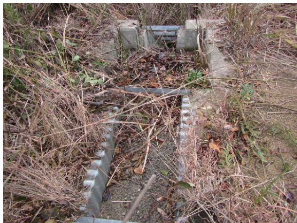
写真-3 水路内への土砂の堆積状況
