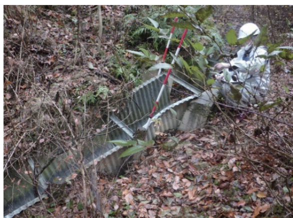
写真-4 水路横の土砂の流出状況
