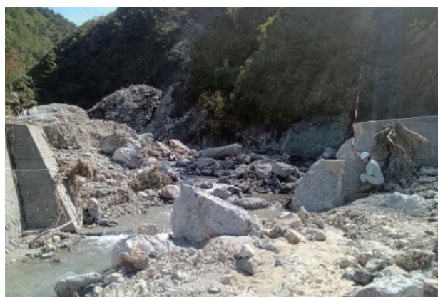
写真5 治山施設の被災状況(石川県珠洲市)
