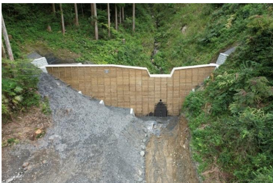
四国森林管理局長賞を受賞した 吉野川上流地区仁尾ヶ内復旧治山工事
