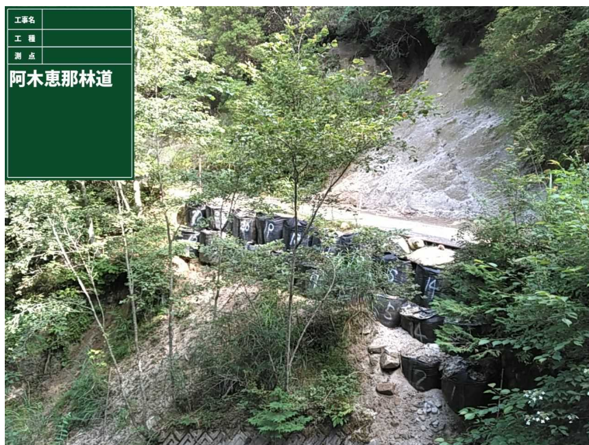
上写真箇所の大型土嚢と災害により崩落したブロック積み
