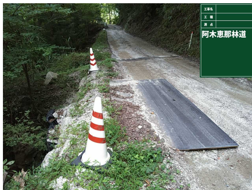
大型土嚢基部の崩落の恐れがある所に危険表示
