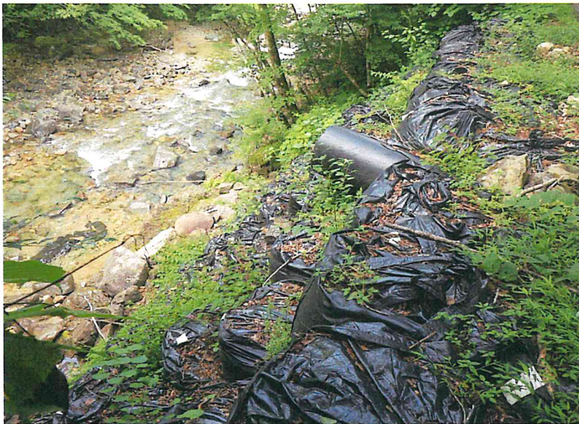
若栃榎谷林道（下） 令和6年7月6日 崩壊箇所現状 路面側から下方向撮影
