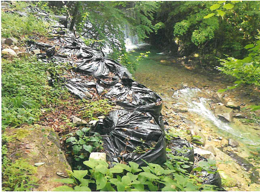
若栃榎谷林道（下） 令和6年7月6日 崩壊箇所現状 下流側から撮影
