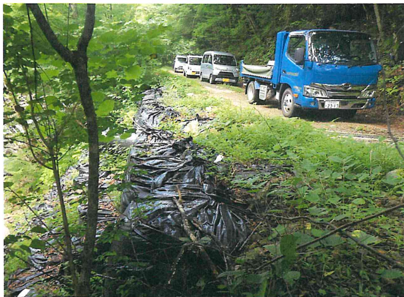
若栃榎谷林道（下） 令和6年7月6日 崩壊箇所現状 工事関係者通勤状況
