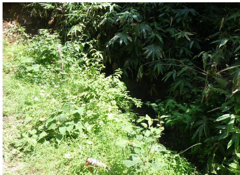
ミソスリ林道 横断暗渠結果箇所 2024/8/7撮影 大型土のうによる 仮復旧 呑口側
