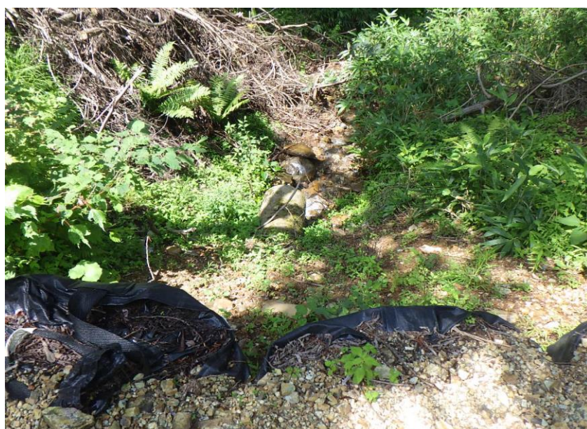
ミソスリ林道 横断暗渠結果箇所 2024/8/7撮影 大型土のうによる 仮復旧 吐口側
