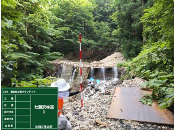
林道崩落箇所の調査
